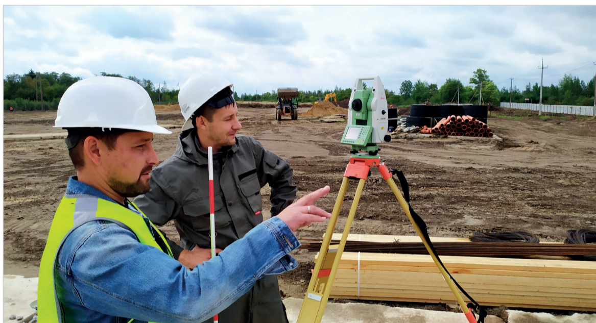
Производитель работ А. Грабовский (слева) и геодезист В. Щерба ведут трассировку стройплощадки нового завода ЗАО «Капри».
